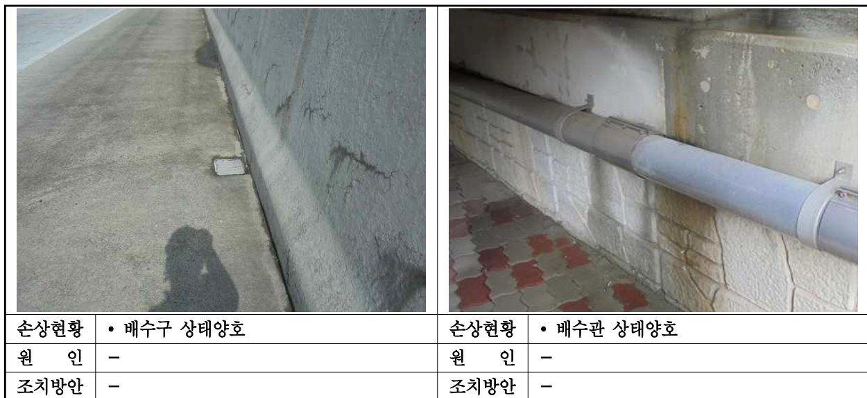
【사진 27.3.20】 배수시설 손상현황
