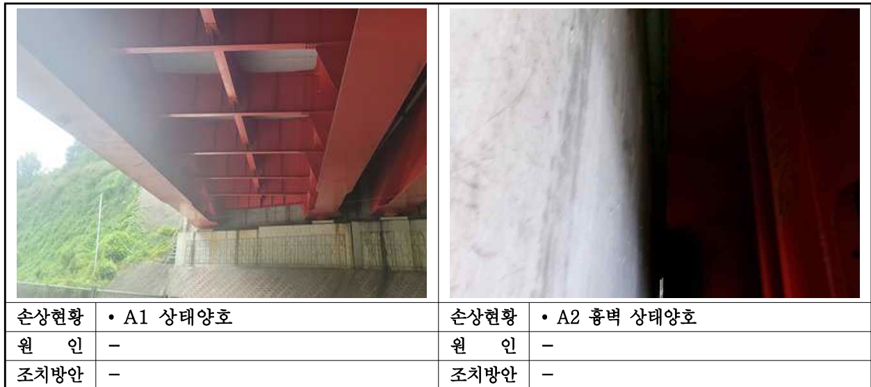
【사진 27.3.9】 교대 손상현황
